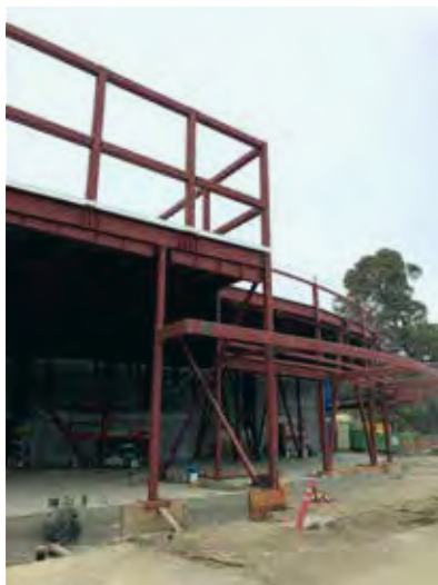
La construcción ya está en marcha en la expansión del Complejo de Educación y Kinesología de la universidad comunitaria de Contra Costa, que ofrece un gimnasio renovado y un Anexo de Gimnasia modernizado.
